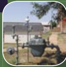
Medidor de gas
